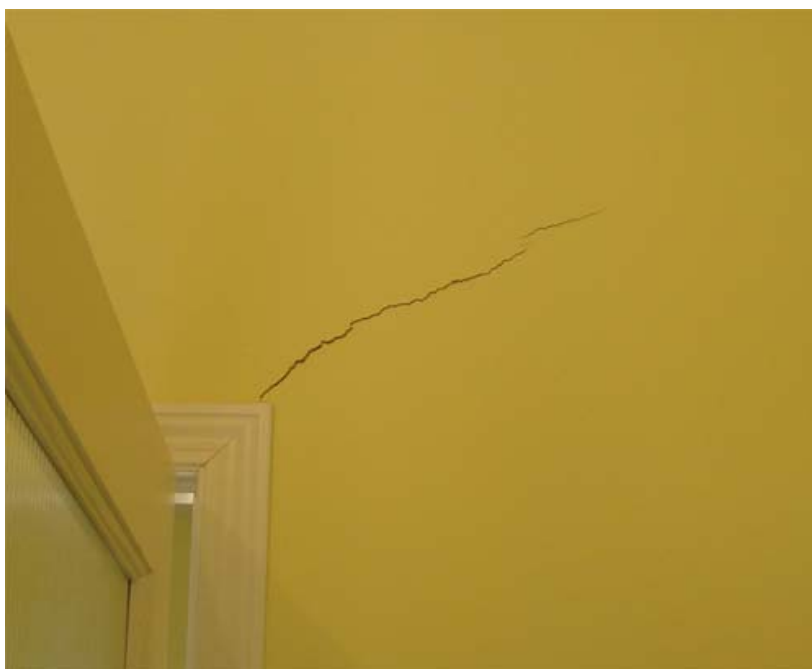
Typische drywall crack
