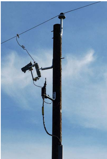
Onze power pole
